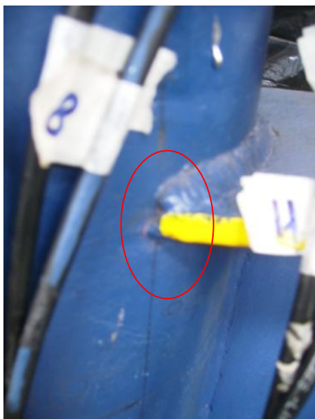
Figura 5.10 - Rompimento da solda no flange superior da viga.
