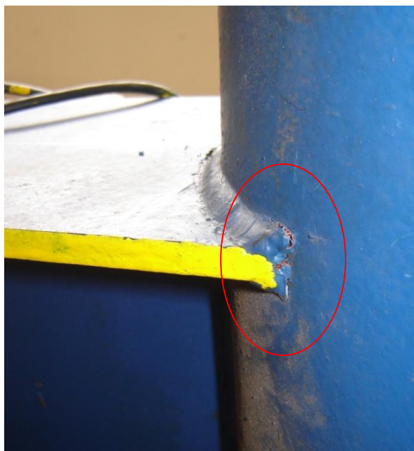
Figura 5.17 - Rompimento da solda no flange superior da viga W 310 x 8,7, coluna 219,1 x 9,5.
