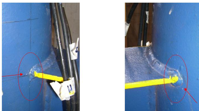
Figura 5.24 - Detalhe do rompimento da solda no flange superior da viga.
