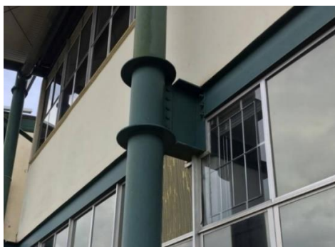
Figura 3 – Ponte térmica condicionada ao material.
