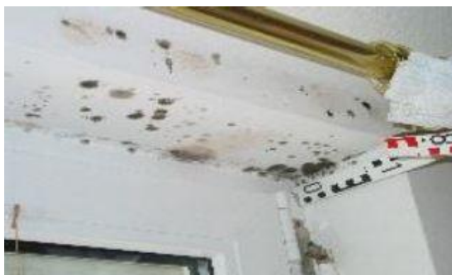
Figura 6 – Aparecimento de bolores provocados por condensação na região da ponte térmica. Fonte: VALERIO, 2007.
